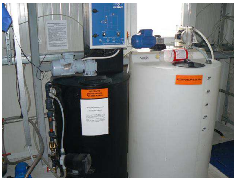
Figura nr. 14 - Instalația de condiționare a lichidului de spălare
